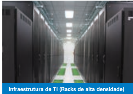
Infraestrutura de TI (Racks de alta densidade)
